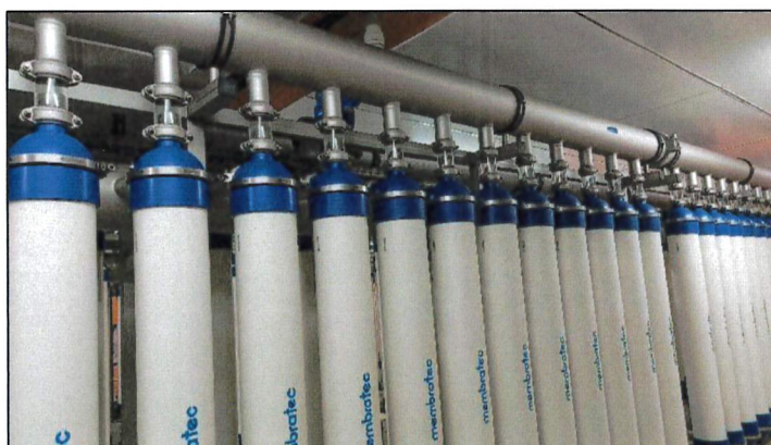
Etape d'ultrafiltration, station des Gonelles
